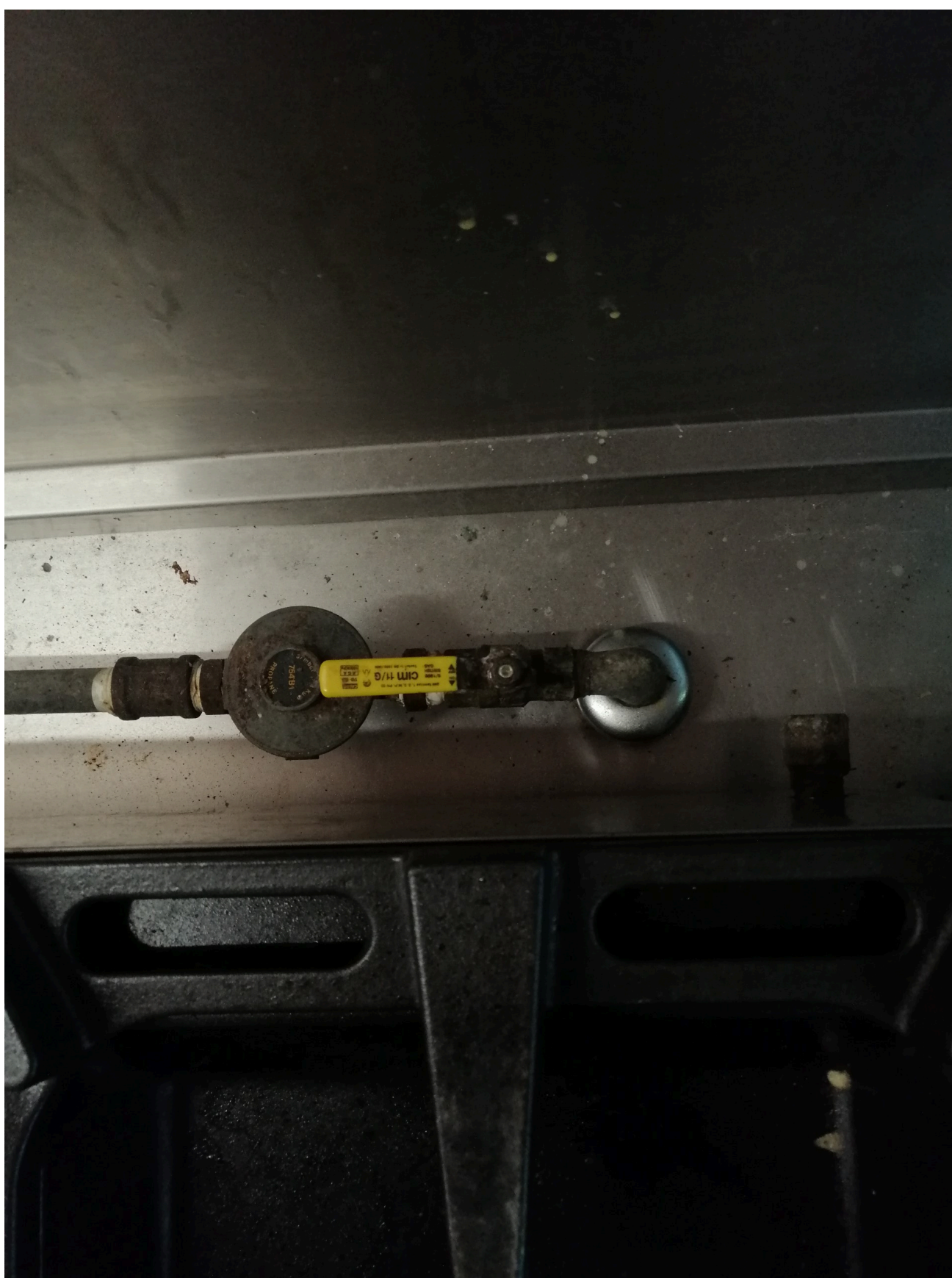
Gas staat open, vuren kunnen gebruikt worden
